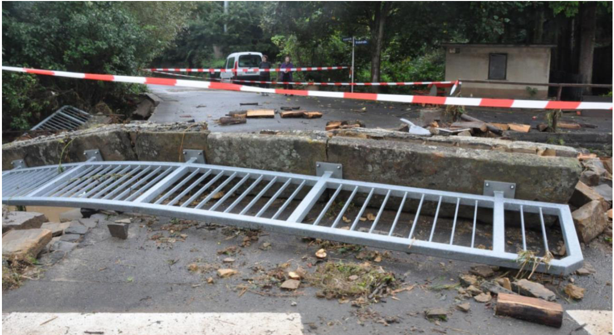
Zerstörte Brücke in Finkenbach-Gersweiler.
