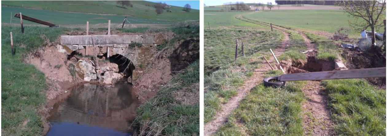
Zerstörter Wegdurchlass in Bisterschied
