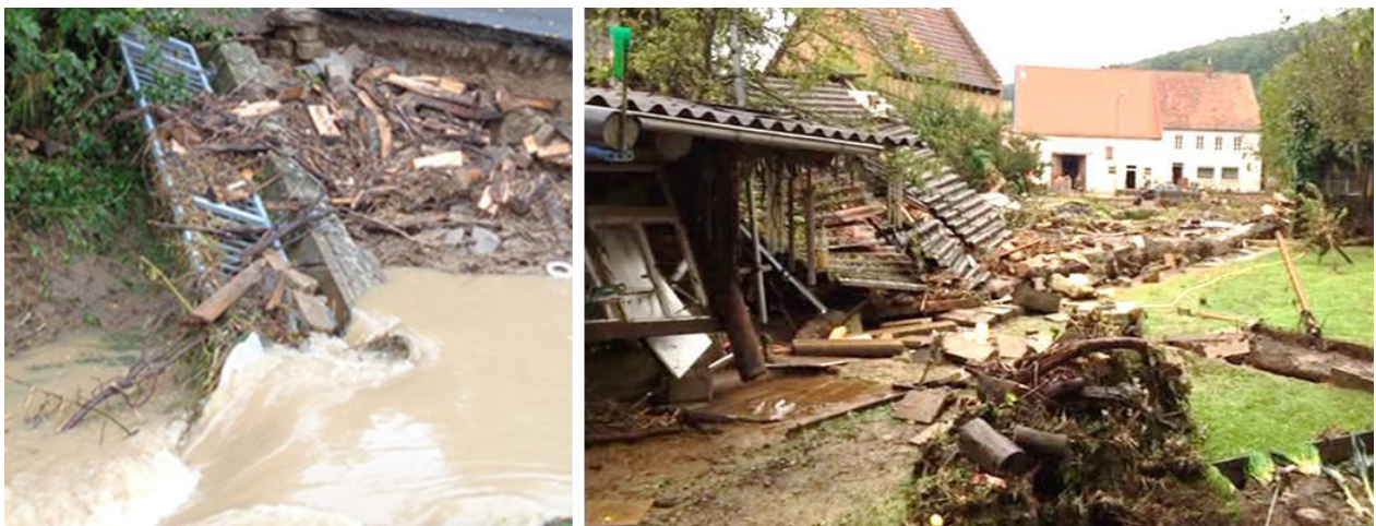
Zerstörte Brücke in Finkenbach-Gersweiler und Flutschneise in Ransweiler im September 2014
